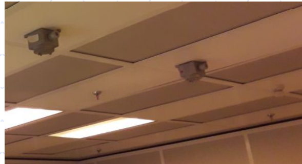
Αισθητήρες ανίχνευσης αερίων και πυρόσβεσης
